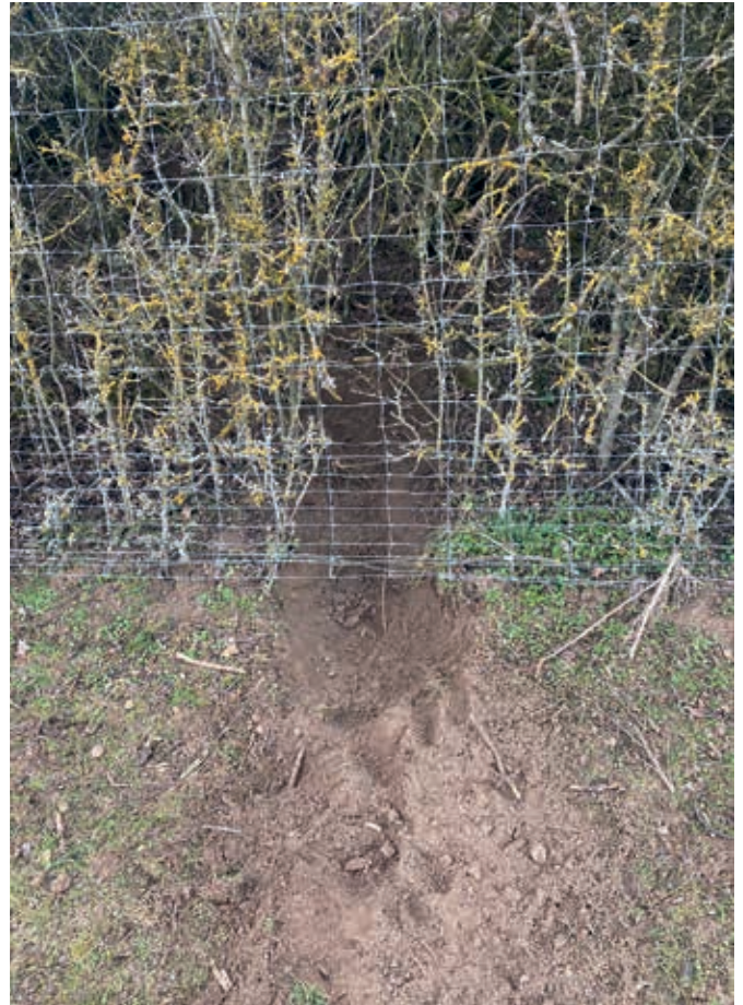
Untergrabener Gehegewildzaun. Ohne zusätzliche Schutzmaßnahmen bietet der klassische Gehegezaun aus Drahtgeflecht keinerlei Schutz gegenüber Wolfsübergriffen.
