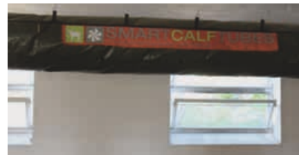
Zuluft über Überdruck in einem perforierten Schlauch, Abluft über Fenster
