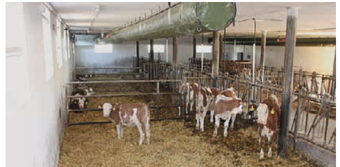
Schlauchlüftung im Kälberstall der Hurler-GbR, Bissingen
